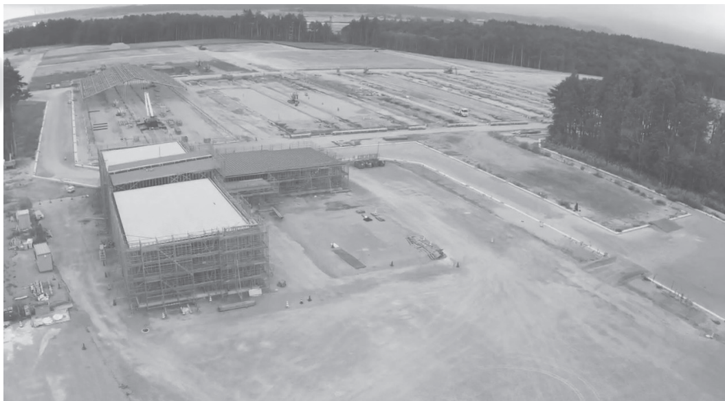
浪江町「復興牧場」建築工事の状況（令和6年9月8日撮影） 写真の手前には「管理研修棟」、その後ろには「牛舎」の建築工事が現在、進んでいます。
